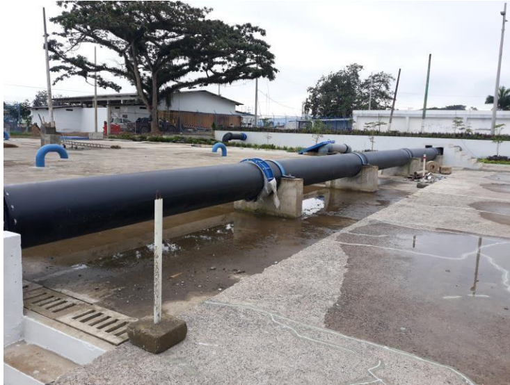
Foto: Tuberías de HD C25 en interconectado de reservas “Tres cerritos”
